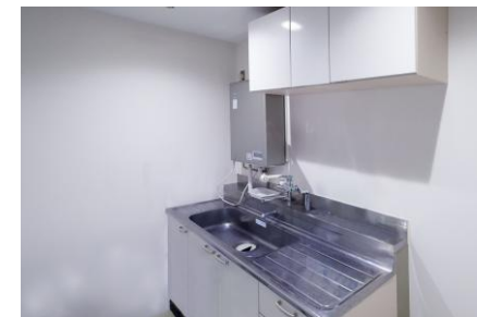
基準階共用給湯室
